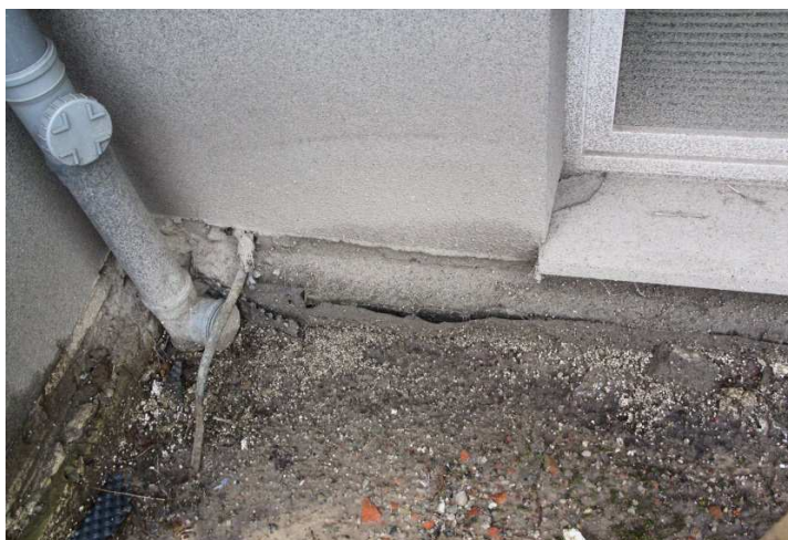
Elewacja północna – brak opaski betonowej – niezabezpieczona izolacja pionowa.
