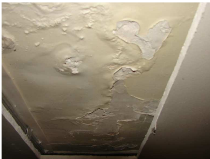
Odkrywka wewnętrzna nr 1 ściany piwnic- widoczne ślady oddziaływania wilgoci.
