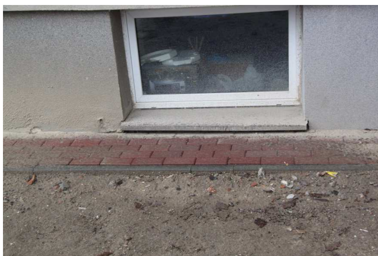
Efekt rozbryzgów wody ściekającej z gzymsów.
