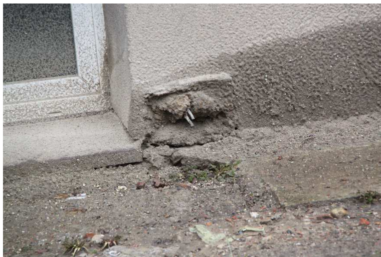
Efekt rozbryzgów wody ściekającej z gzymsów.
