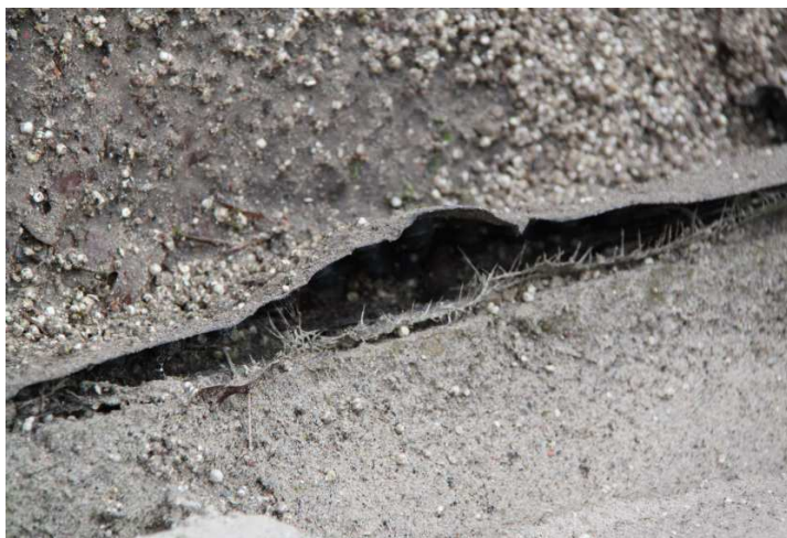
Elewacja północna – odspojona i niezabezpieczona izolacja p.wilgociowa pionowa ściany.
