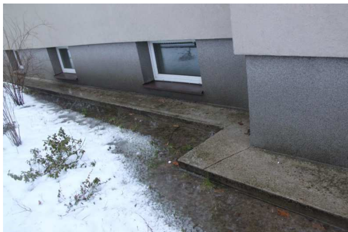
Zastoiska wód opadowych przy budynku.
