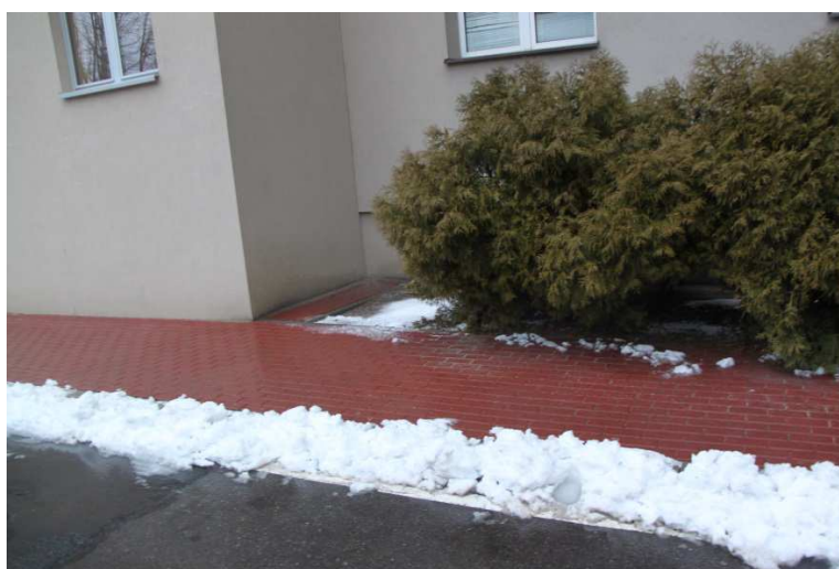
Odwrócony spadek opaski – spływ wód w kierunku ściany.
