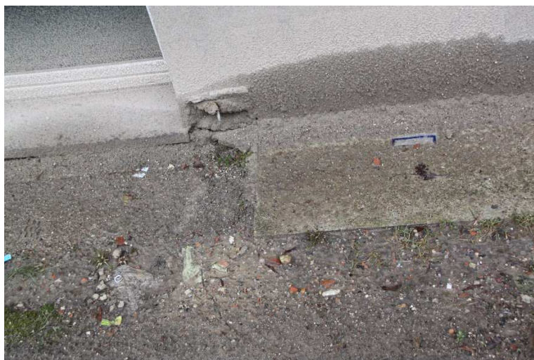
Zawilgocona ściana w wyniku rozbryzgów wody.
