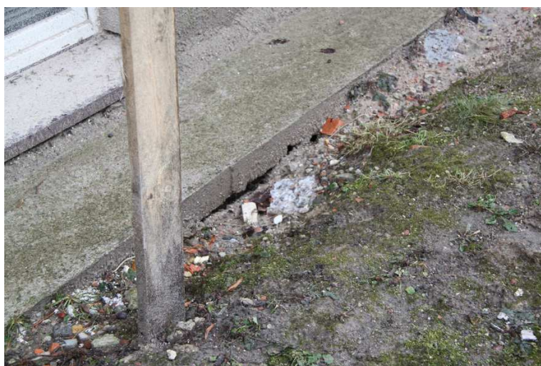
Zapadnięty grunt nasypu.
