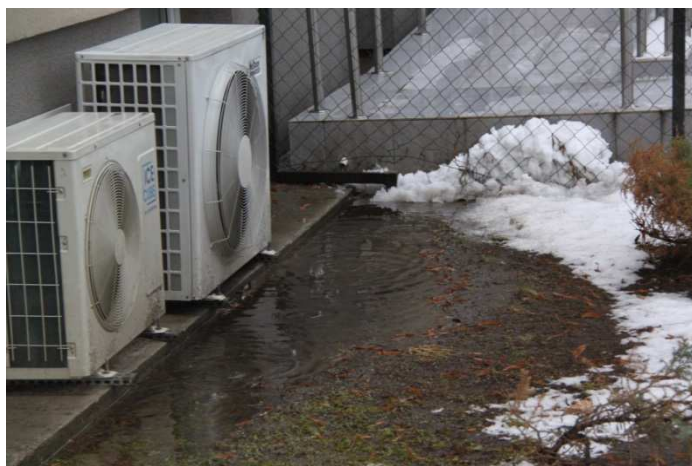
Zastoiska wód opadowych przy budynku.
